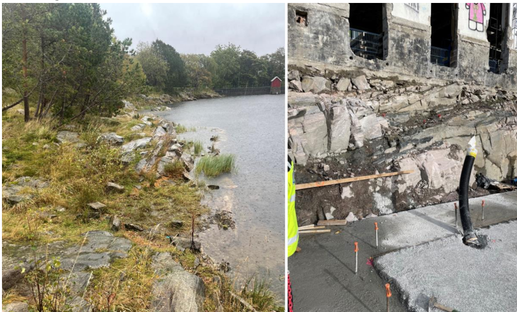
Figur 3: Bilder fra områder med antatte svakhetssoner. Venstre bilde viser deler av nordre svakhetszone med tydelige åpne sprekker i ØV-retning og forsenkning i terrenget, bildet er tatt mot vest. Høyre bilde tatt mot nordre vegg av byggegrop til Normoria som muligens sammenfaller med søndre svakhetszone, det er ikke observert tegn til svakhetssonen i det aktuelle området.
